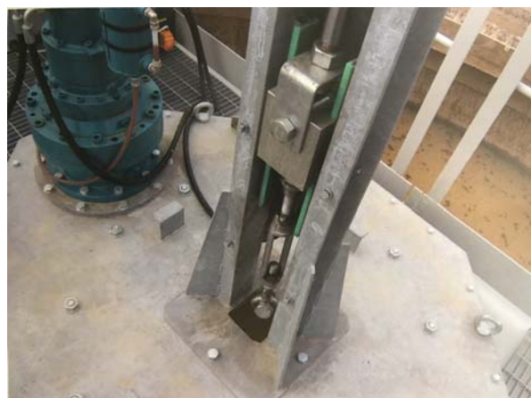
Sistema idraulico sollevamento raschie – Particolare senza protezione di sicurezza
