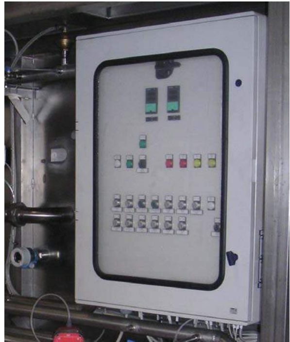
QUADRO DI CONTROLLO AUTOMATICO AUTOMATIC CONTROL PANEL
